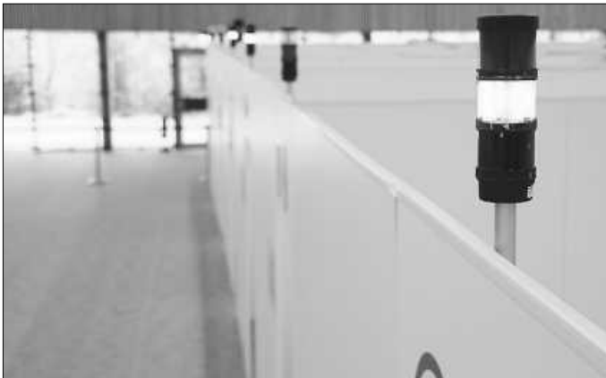
Signalsäulen-Set regelt Zutrittskontrolle zu den Impfkabinen
